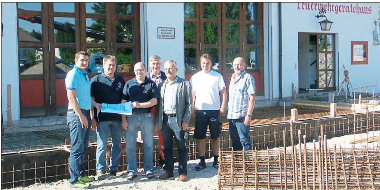
Verantwortliche von Feuerwehr und Gemeinde informieren sich über den Baufortschritt des Anbaus an das Feuerwehrhaus.
