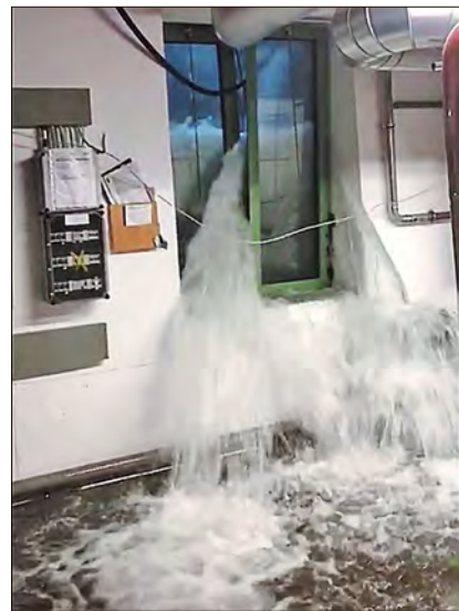
Am Mittwochnachmittag regnete es in Konzell so stark, dass ein Keller bei der Firma Bischof und Klein volllief. Laut Werksleiter Armin Kienberger stand das Wasser in einem Raum zeitweise fast zweieinhalb Meter hoch.
