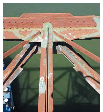
Am grauen Farbton gut zu erkennen sind die 2006 sanierten Flächen.
