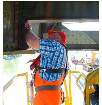
Mit Gefühl – und Hammer – ist Bartholomäus Trettenbach dem Rost auf der Spur...
