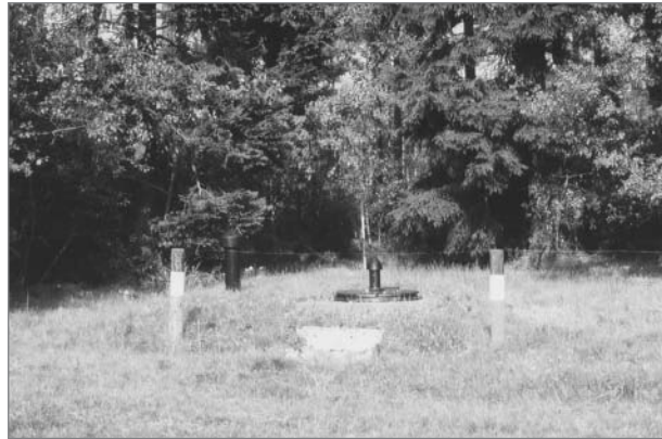
Sammelstelle der vier Quellen für die Falkenfelder Wasserversorgung
