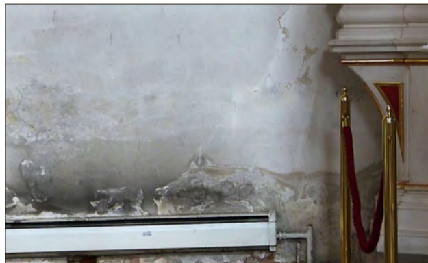
Die Kirchenwände über den Heizungen sind derzeit stark verrußt.
