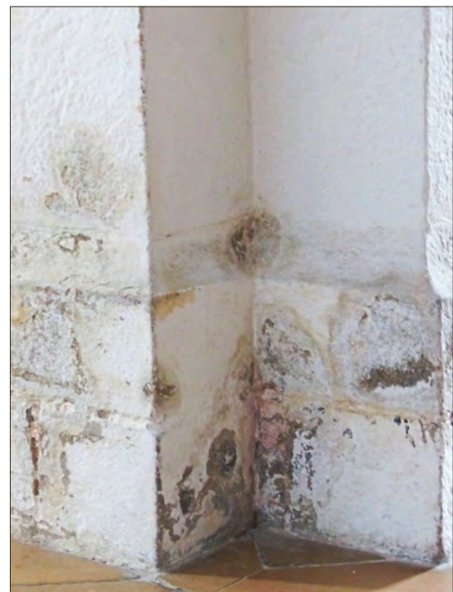
... sowie am abgeblätternen Putz am Durchgang von Sakristei und Hochaltar.
